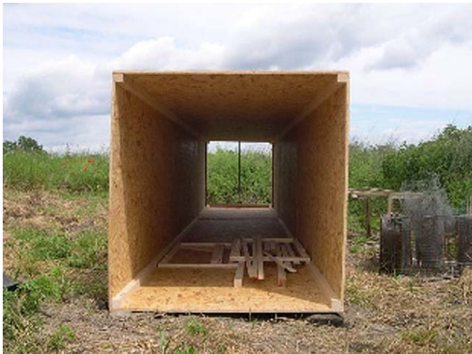
Abbildung.5: Rohkörper des Versuchstunnels horizontal und nach Norden ausgerichtet. Die Gesamtlänge beträgt 7.50 m.
